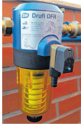
Symbolbild eines Hauswasserfilters der nach dem Trinkwasserzähler installiert ist.
