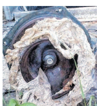
Verstopfte Pumpen durch Feuchttücher bereiten den Wasserwerken zunehmend Sorgen
