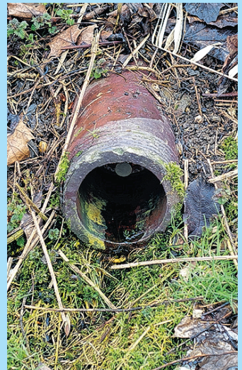
Ein vom ZWW verschlossenes Drainagerohr aus dem Quellgebiet in Lenkersdorf (Zwönitz)
